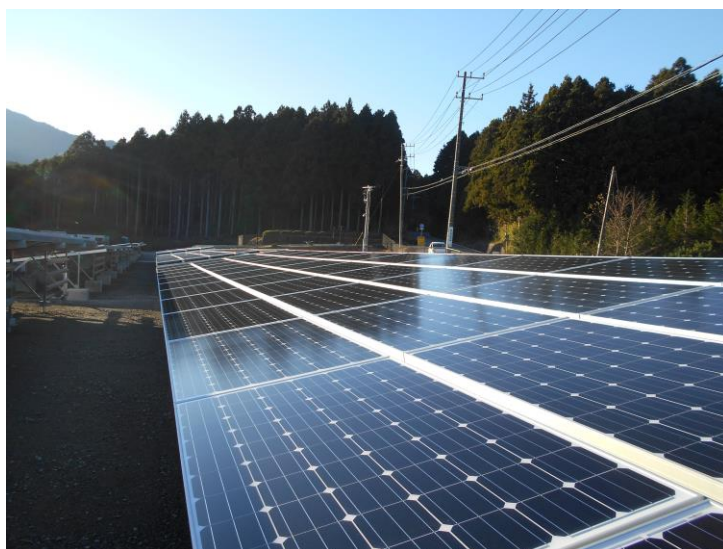
弊社の既存の太陽光発電（須山第二発電所）
